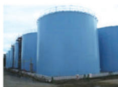
溶接型タンク
